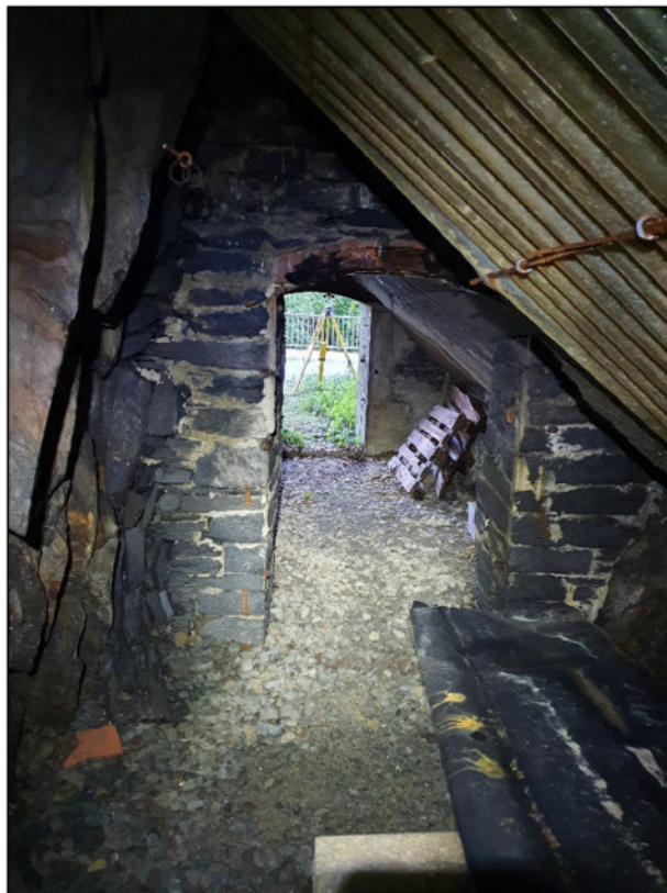
Abb. 6: Tropfschutz und Mauerung
