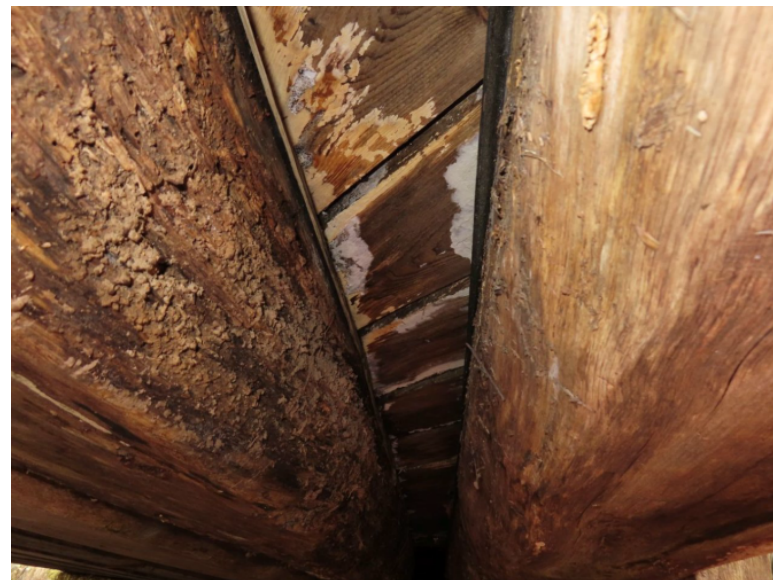
Pilzbefall an Trägern
